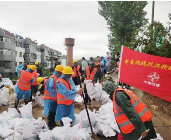
中交集团受灾项目现场抢险情况
