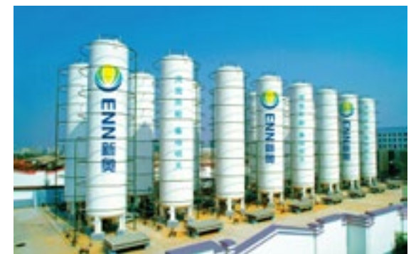
新奥清洁能源 LNG 储区
