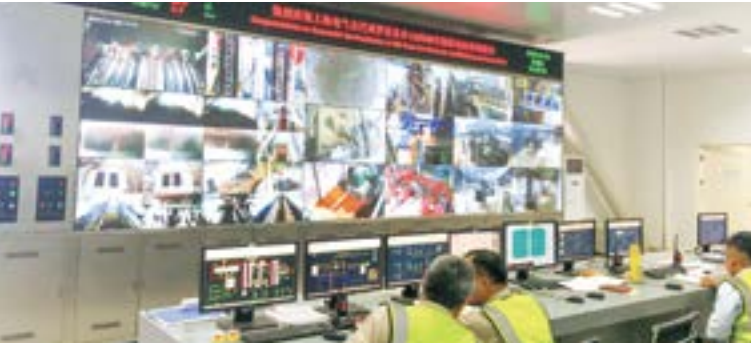
上海电气环保集团，古巴西罗雷东多 1X60MW 生物质电站项目并网成功
