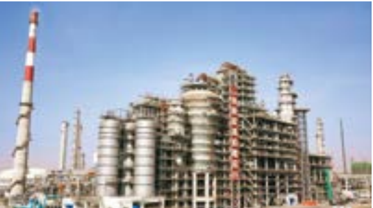
• 神华榆林能源化工有限公司
