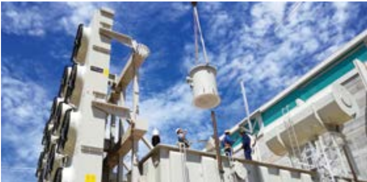
• 中国西电集团所属西电西变研制的 14 台换流变压器在巴西美丽山二期工程的实验现场
